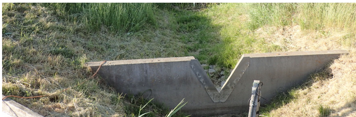
Figur 4 Dammen har en yta på 0,08 ha är indelad i tre delar, där vattnet först leds in i ett litet område avgränsad med en uppdämning i betong med ett 60° V-överfall som baserat vattennivån. Detta har gjort det möjligt att beräkna vattenflödet slang för automatisk flödesstyrd provtagning synlig till höger på bilden.
